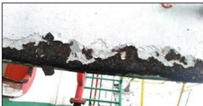
Gambar 4. Karat Pada Weather-tight Door
