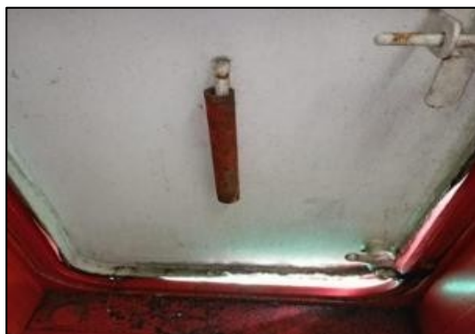
Gambar 5. Weathertight Door Tidak Dapat Tertutup Dengan Sempurna
