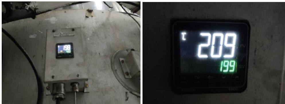
Gambar 4. Indikator temperature/suhu dari uap boiler yang sudah menunjukkan kenaikan hingga 209 0 C
