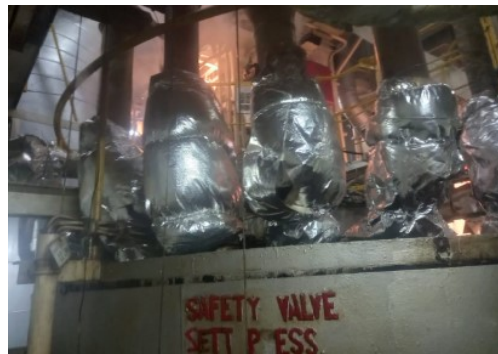
Gambar 2. Safety Valve, jalur uap keluar jika tekanan dalam boiler diatas standart yg sudah ditentukan
