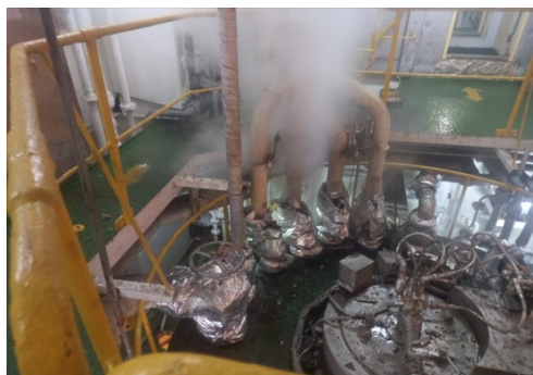
Gambar 1. Uap bercampur fuel oil bertekanan yang menyembur keluar dari boiler menyebabkan kamar mesin kotor karena uap air dan minyak
