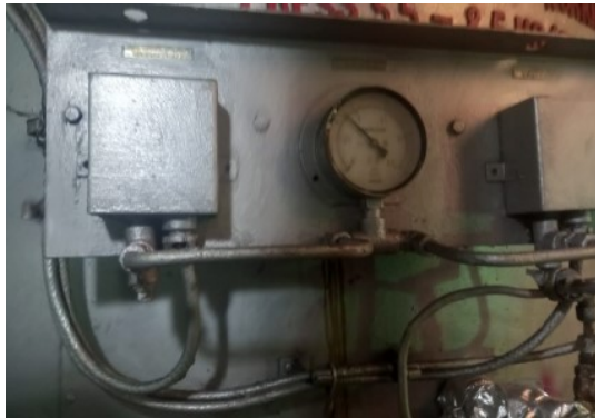
Gambar 3. Indikator tekanan uap dalam boiler yang menunjukkan kenaikan
