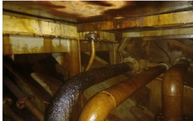
Gambar 10. Kondisi bagian bawah boiler yang berkarat dan kotor
