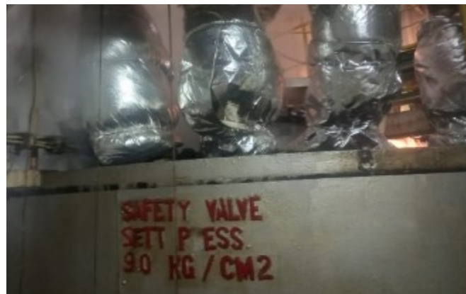
Gambar 9. Safety valve yang sudah di setting dengan tekanan pada 90Kg/Cm 2
