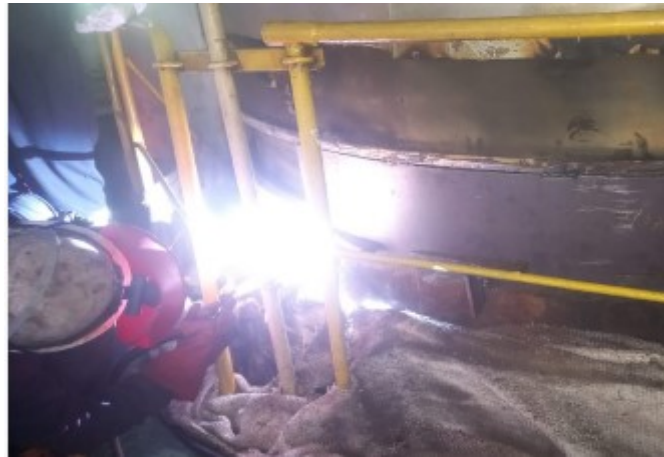
Gambar 12. Reparasi pada bagian expansion ring yang retak/bocor dengan pengelasan
